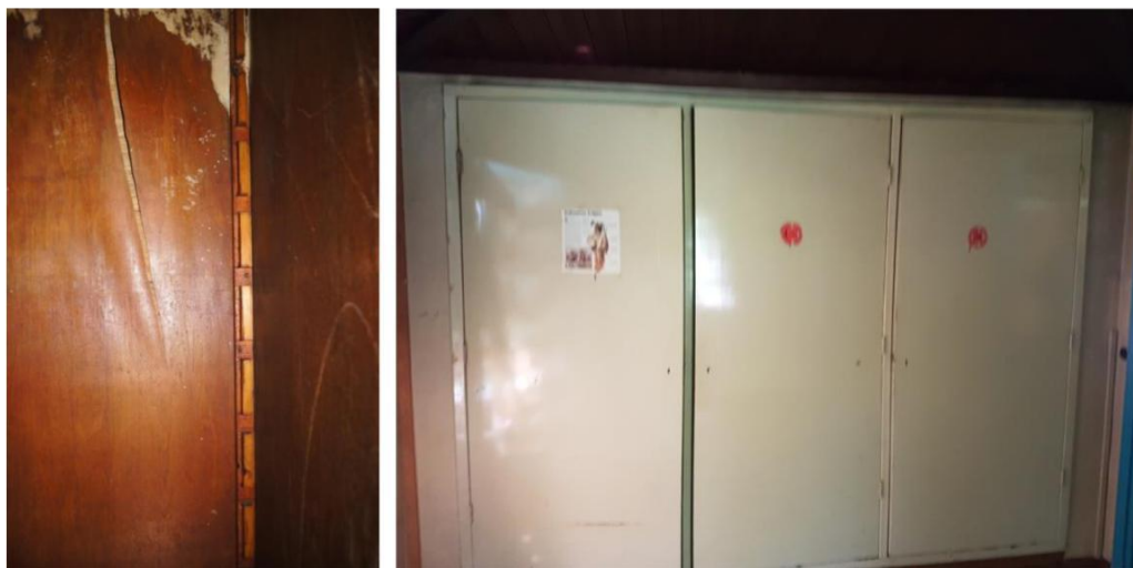
Afb. 63 t/m 66 Van boven naar beneden: houtenplafond; noordwesthoek met vloer en kast; binnenzijde kast (fineer); inbouw kast met drie deuren.
