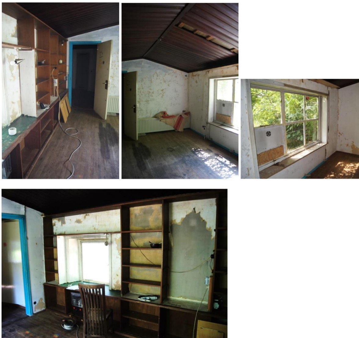
Afb. 59 t/m 62 Van boven naar beneden: entree; overzicht met houten plafond; stalen 6-lichtsvenster; overzicht boekenkast met venster geïntegreerd.
